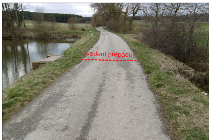
Přepad z rybníka 14c - staničení 1,348 - celkový pohled
